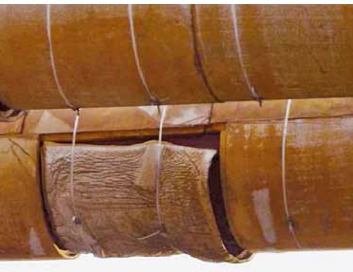
Рисунок 1. Проблемы ППУ скорлуп в результате несоблюдения правил монтажа, температурного режима и технологии производства
